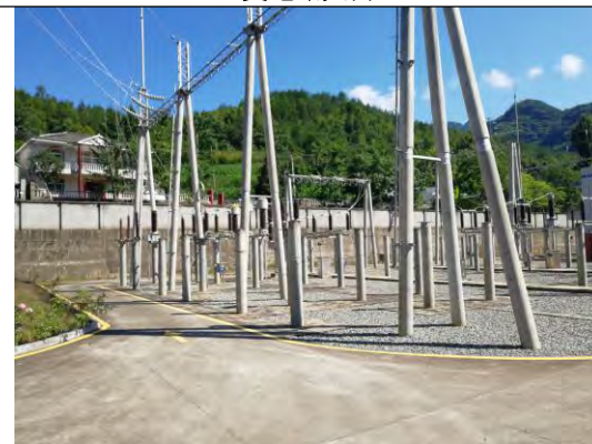
110kV 开关设备场
