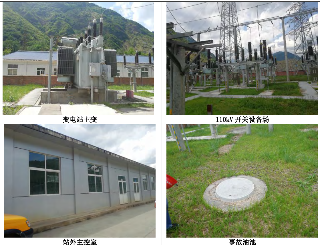
图 4-3 南坝水电站升压站情况
