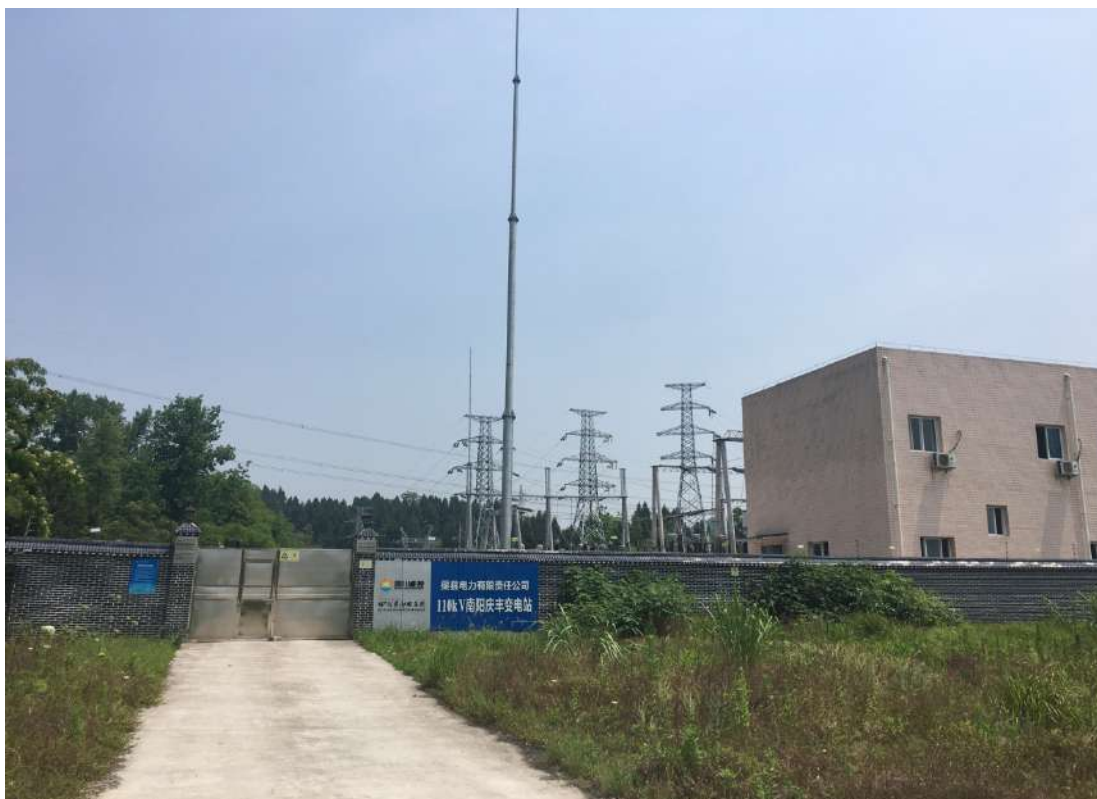
项目起点 110kV 南阳庆丰变电站
