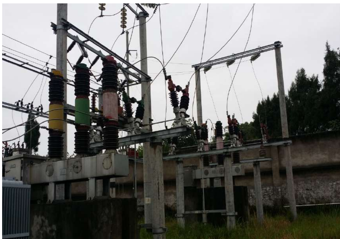
项目终点 35kV 龙潭变电站出线间隔
